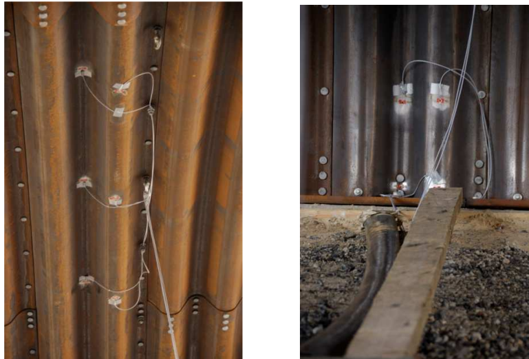
Rys. 4. Rozmieszczenie czujników tensometrycznych na górze i dole fali arkusza blachy. Fig. 4. Location of gauges on the top and bottom ends of the steel plate corrugation.
